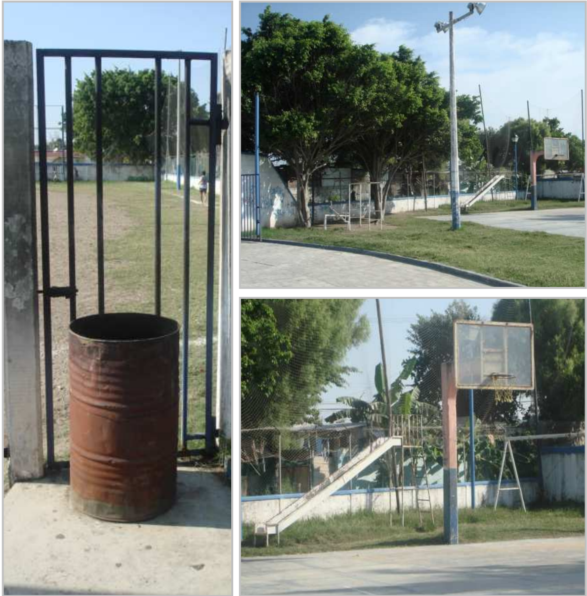
FIGURA 55.- Imágenes que muestran el alto deterioro en todo el lugar.
