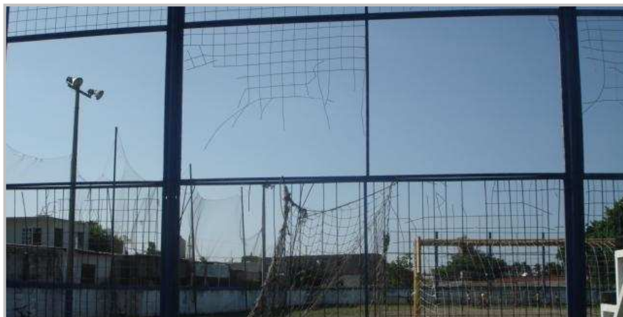
FIGURA 52.- Malla de protección destruida.
