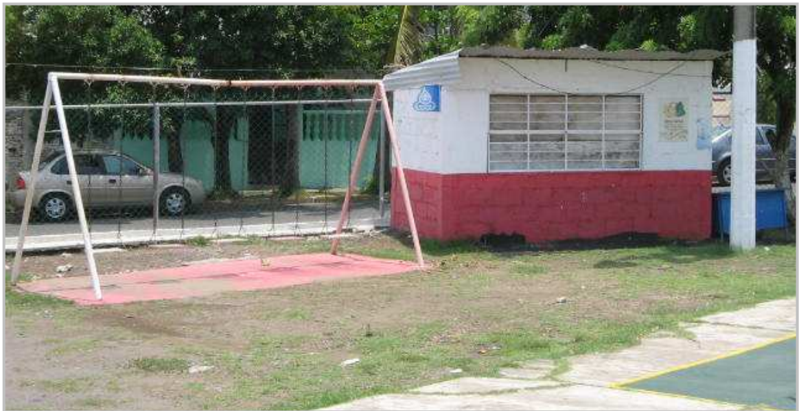
FIGURA 60.- Deterioro en las instalaciones existentes.
