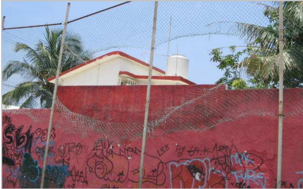
FIGURA 65.- Malla de protección destruidas.
