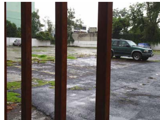
Piso de concreto con brotes de pasto.
