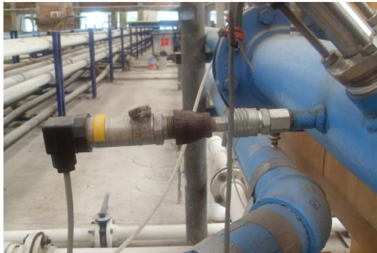
Figura 2.10: Sensor de presión piezo-resistivo ensamblado en la tubería
