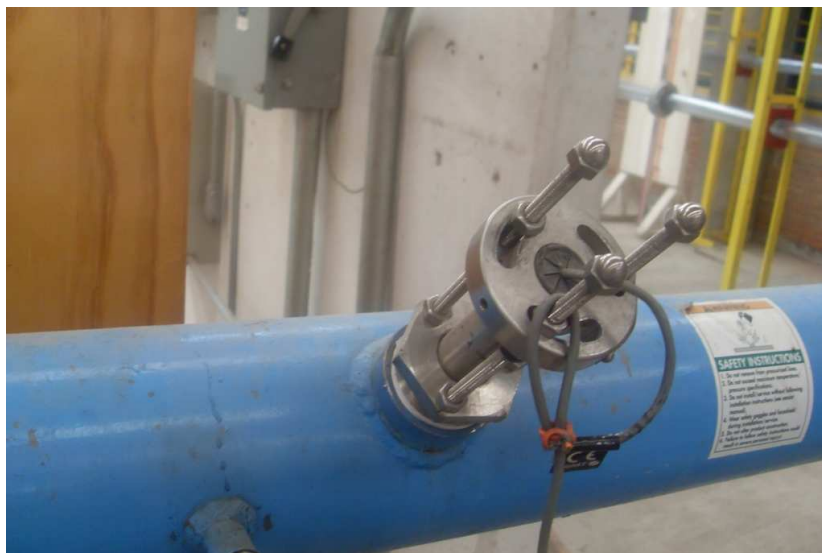
Figura 2.9: Sensor de flujo tipo propela ensamblado en la tubería
