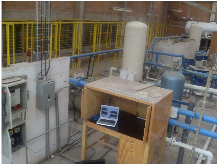
Figura 2.2: Panel de control ( Laptop ) de la planta piloto en el primer plano
