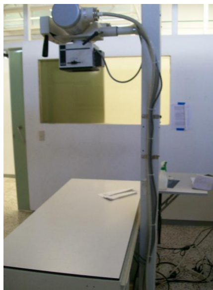
Figura 5: Tubo montado en el piso. Cortesía del Hospital de Especialidades Veterinarias FMVZ 2008.
