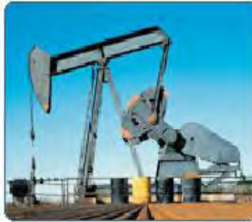
Figura 4.2. Bombeo del petróleo
