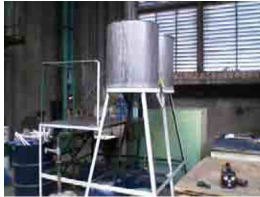
Tanque para preparación y almacenamiento del electrolito
