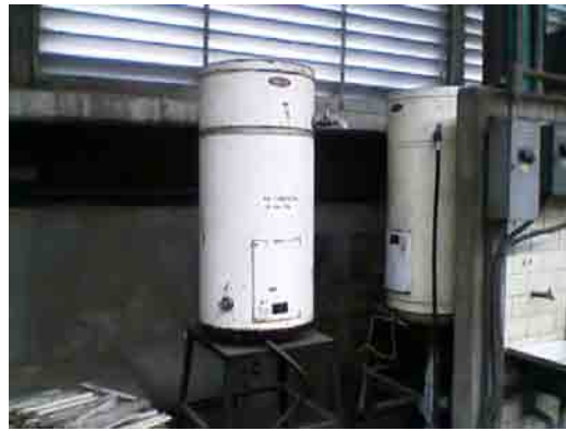
Calentador de agua para el lavado de baterías
