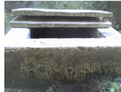
37.-Cajas donde se almacena el agua
