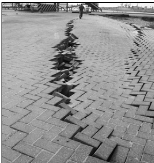
Figura 2.16. Desplazamiento lateral en el puerto de Manzanillo. (Wartman, et al., 2003)
