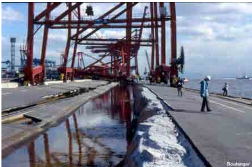
Figura 2.3 Daños debidos a licuación del suelo en el puerto de Kobe, Japón. Tomada de cee.engr.ucdavis.edu/faculty/boulanger/geo_photo_album/
