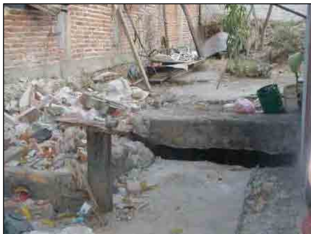
Figura 2.15. Hundimiento de piso en Villa de Álvarez, Colima. ( Bitrán, et al., 2003 )
