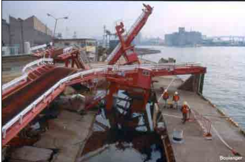
Figura 2.2 Daños debidos a licuación de suelo en el puerto de Kobe, Japón. Tomada de cee.engr.ucdavis.edu/faculty/boulanger/geo_photo_album/
