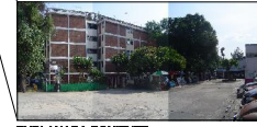
EXPLANADA PONIENTE. Existe un Alto Grado de Acosamiento (poca vegetación arborea), así como, graffiti. Falta de Carácter arquitectónico que lo identifique.
