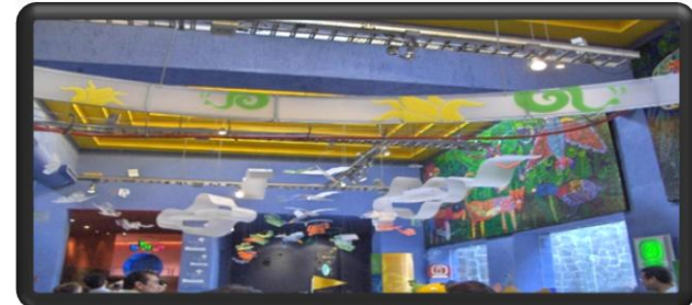
INSTALACIONES EXPUESTAS DENTRO DE LAS SALAS.
