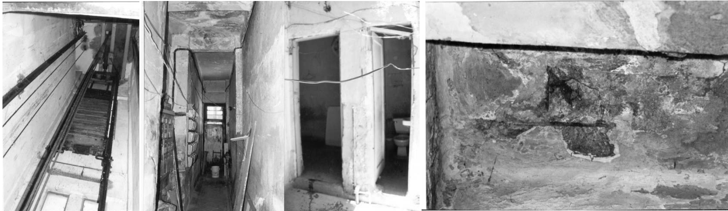
Edificio Casas Jardines vistas del cubo del elevador, acceso de servicio, sanitarios improvisados y deterioro en losa, fotografías tomadas en el año 2002
