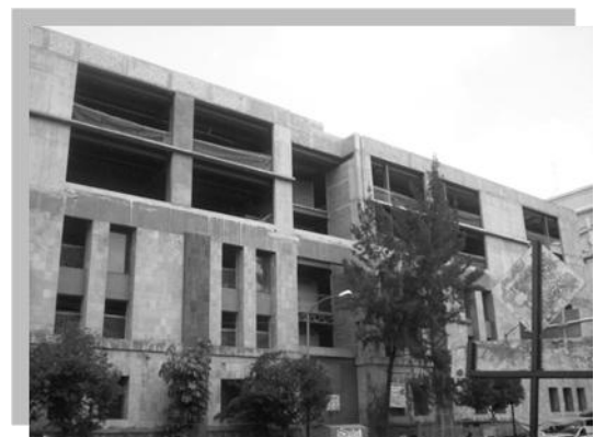
Ubicación: Balderas 27, esquina Av. Juárez, colonia centro, Delegación Cuauhtémoc. Estado: Inmueble en proceso de reconstrucción, cuyo permiso vence en diciembre de 2010
