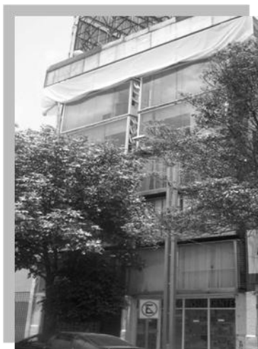
Ubicación: Chapultepec No. 318, colonia Roma, Delegación Cuauhtémoc. Estado: Inmueble antiguo que presenta grietas en su fachada.
