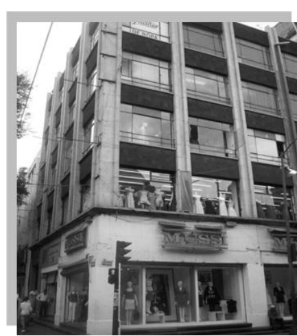
Ubicación: Av. 20 de noviembre, No. 136, colonia centro, Delegación Cuauhtémoc. Estado: Construcción vieja con evidentes fisuras en su estructura.
