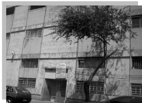
Calle Héroes No. 24, colonia Guerrero, Delegación Cuauhtémoc. Estado: Inmueble en mantenimiento por parte de un programa Delegacional.
