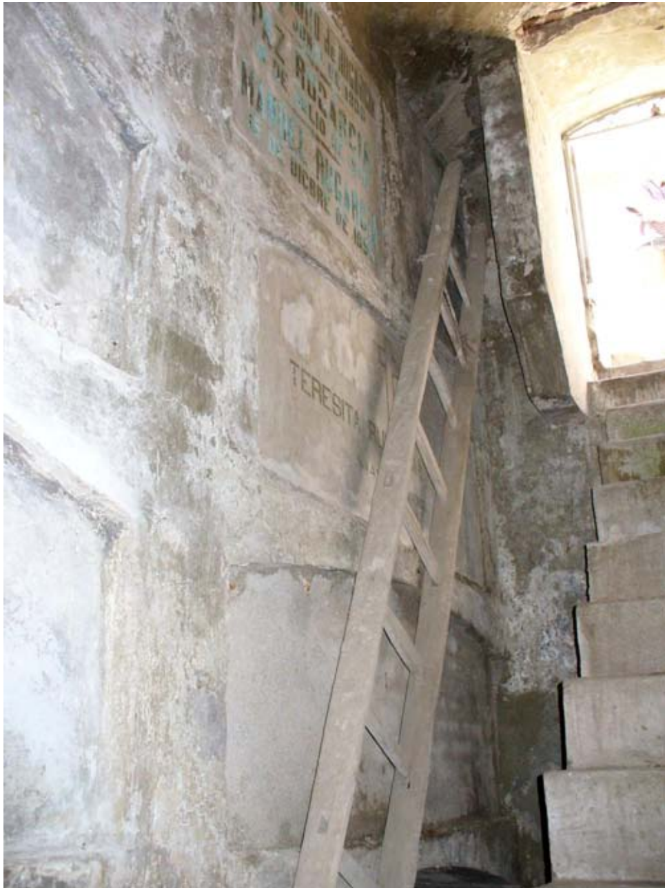
Figura 20. Vista parcial de la pared del lado derecho de la cripta en nuestra primer visita. Foto: Gerardo Valenzuela J.
