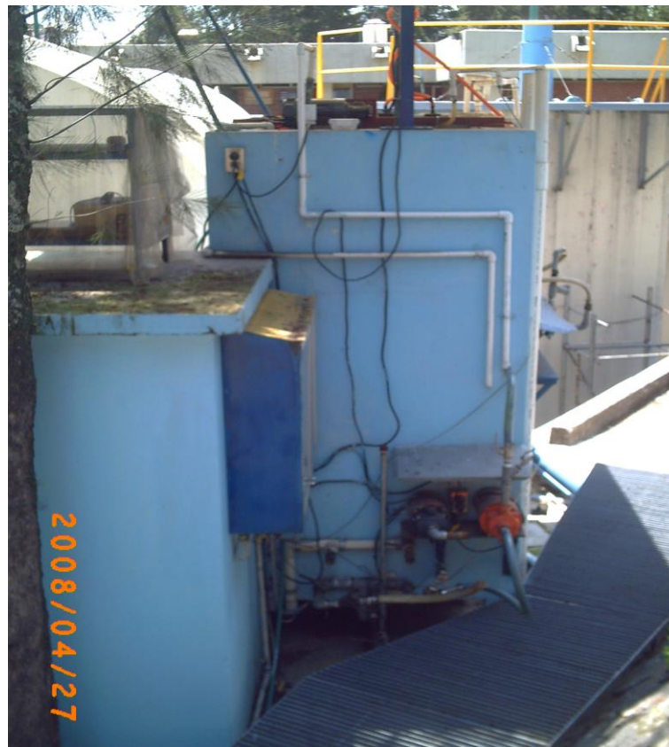
Figura 4.3. Vista lateral del reactor fermentador.
