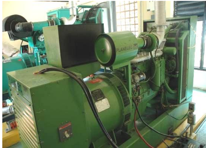
Figura 2.9. Generador de emergencia
