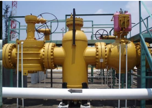
Figura 2.3 b. Filtros FV-01/02
