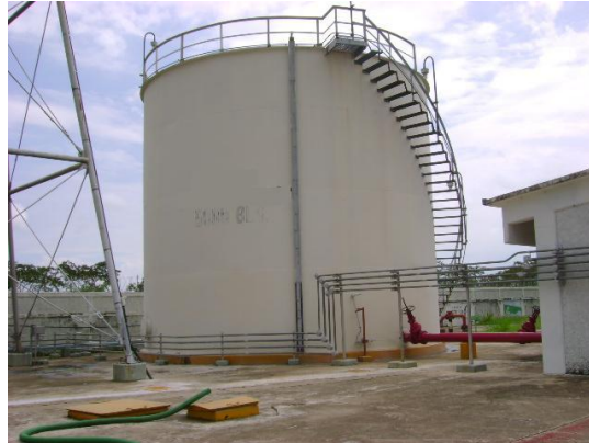
Figura 2.6. Tanque de almacenamiento TV- 01
