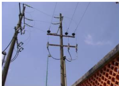
Figura 2.8. Postes de luz de la estación de bombeo
