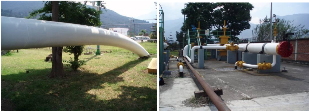
Figura 2.2. Ductos de llegada
