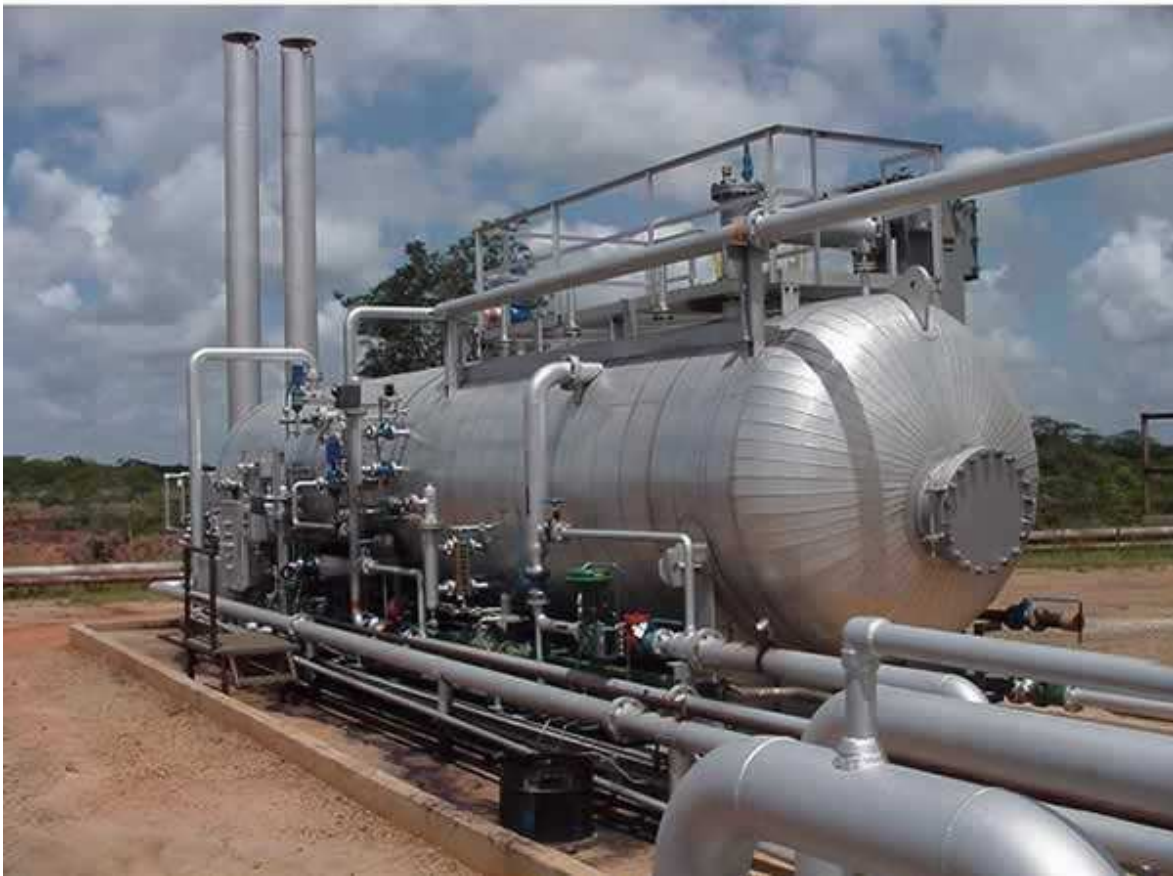
Figura 6.5 Tratador térmico, (Brant, F., 2006).
