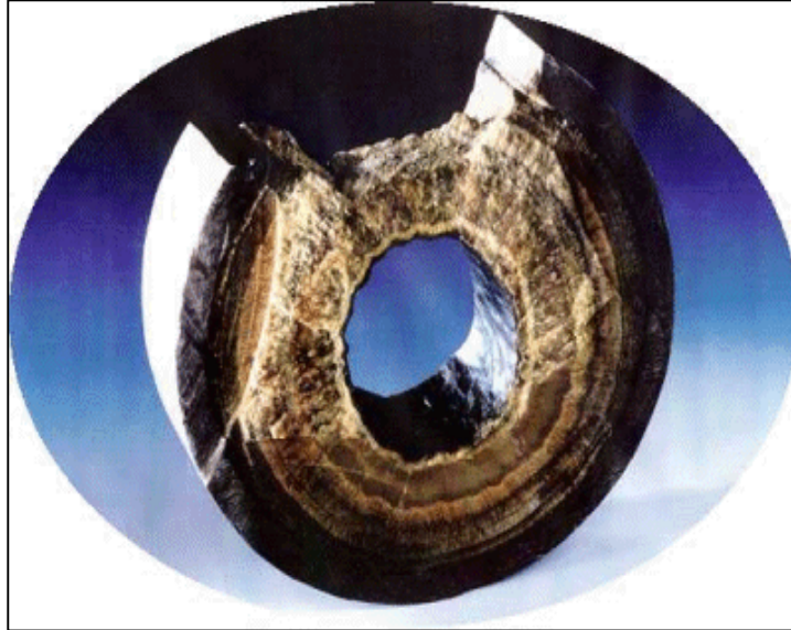
Figura 7.4 Incrustación de \text{CaCO}_3 en una tubería (PEP, 2008).
