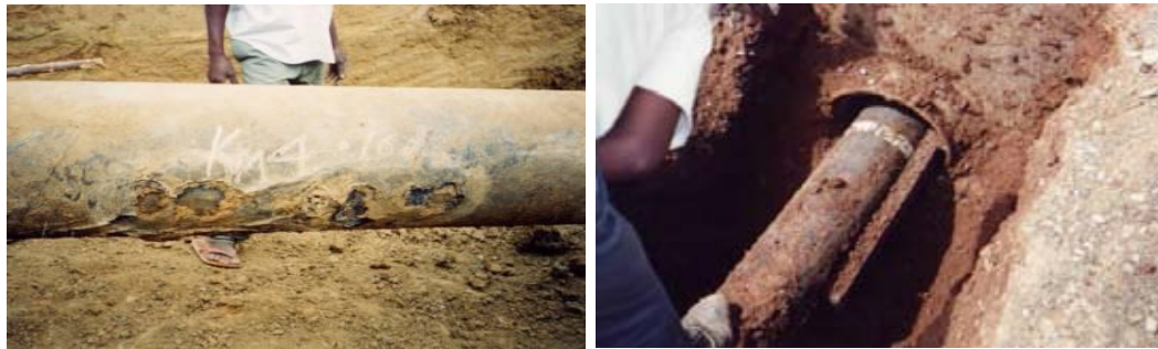
Fig. 2.7 Corrosión de Ductos
