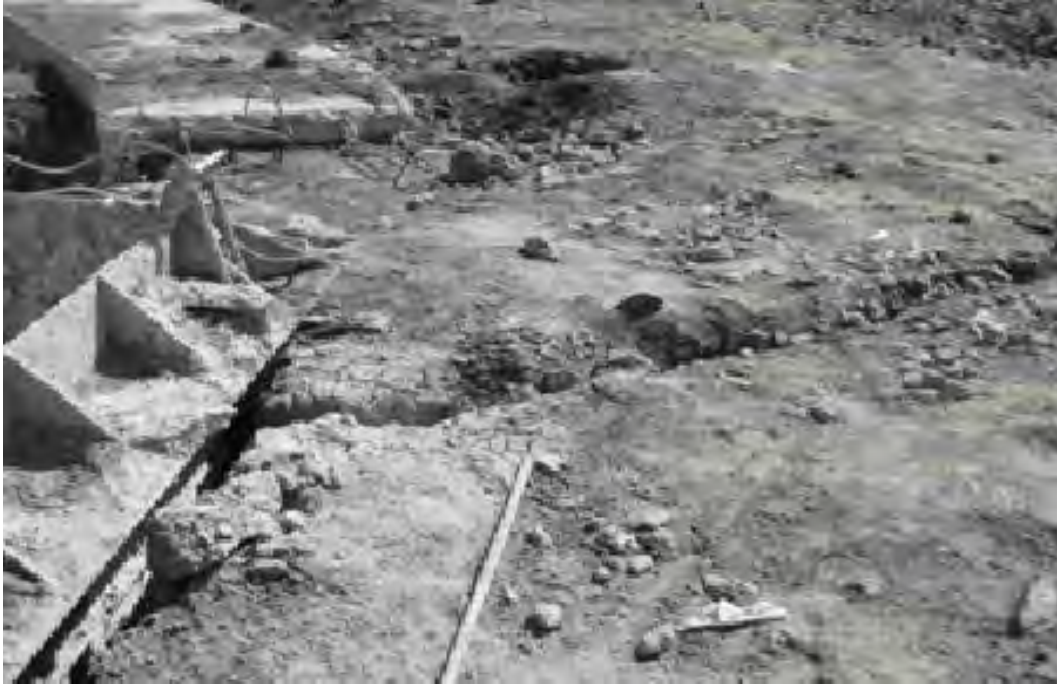
Figura 3.10 Agrietamiento inducido por la presión de lodo autofraguante en un panel de una pared colocada in situ (Lumbrera 3, Túnel Río de los Remedios).
