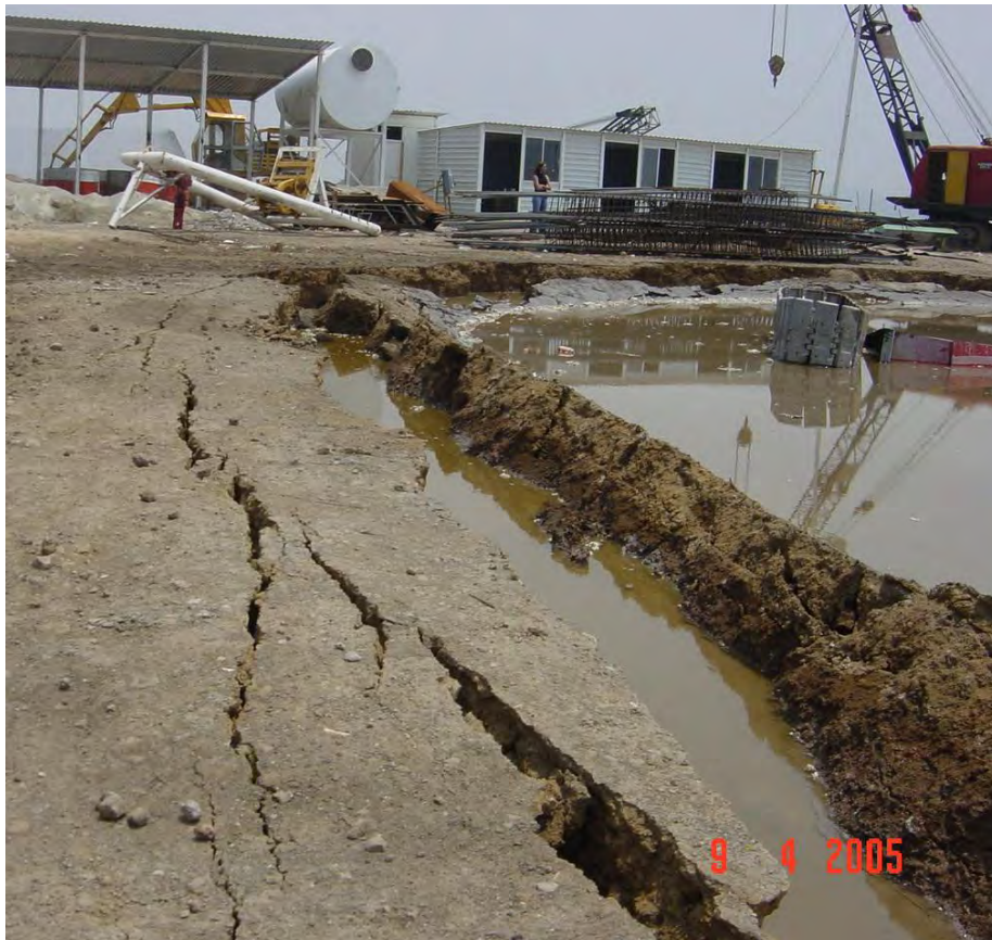
Figura 3.20 Falla lumbrera L6 del Túnel del Río de los Remedios
