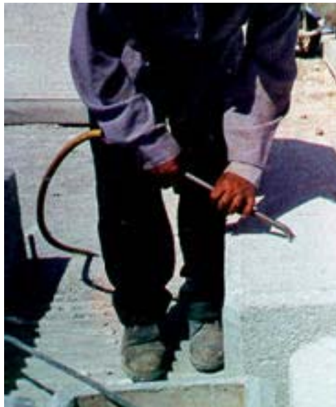
Fig. 3.18. Desescamado de concreto por medios mecánicos
