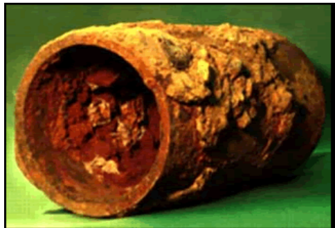
Apariencia del proceso de corrosión. 100
