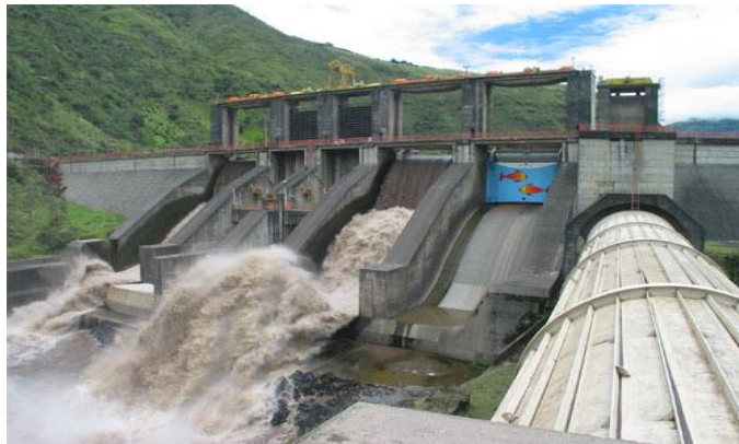
Figura 1.5. Central hidroeléctrica, CFE, 2009.
