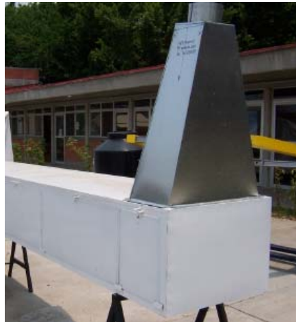
Vista de la chimenea en el deshidratador del CIE Temixco 2008 [El autor]
