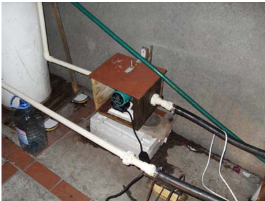
Vista de las conexiones y tuberías.
