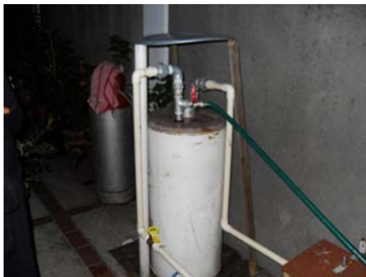
Vista del boiler de prueba
