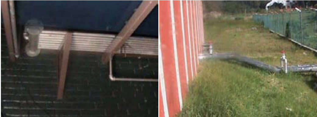
Intercambiadores de calor en la estufa de secado de madera y tubería de calefacción geotérmica en los Azufres Michoacán [El autor]
