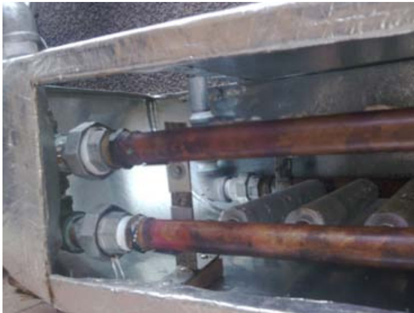
Vista de los tubos principales del intercambiador de calor.
