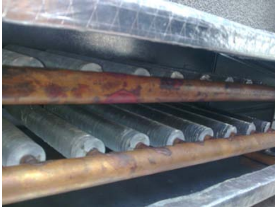
Vista de la tubería aletada.
