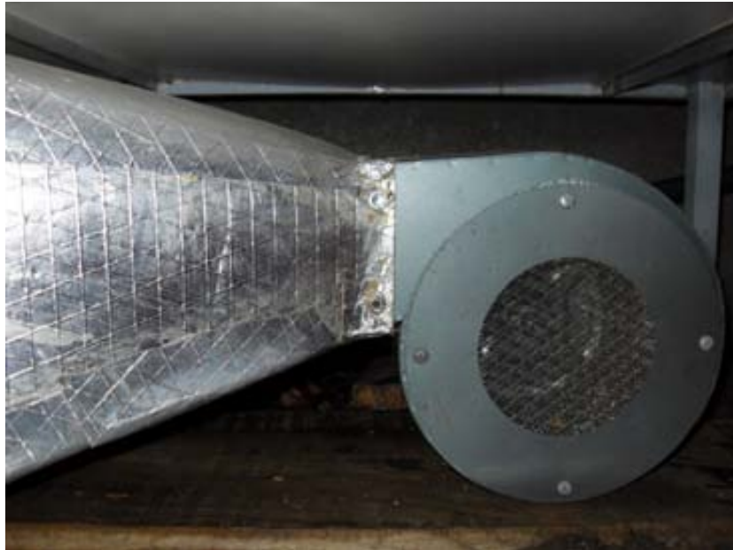
Vista del filtro del ventilador y el difusor al túnel.
