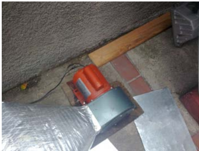
Vista del motor del ventilador.
