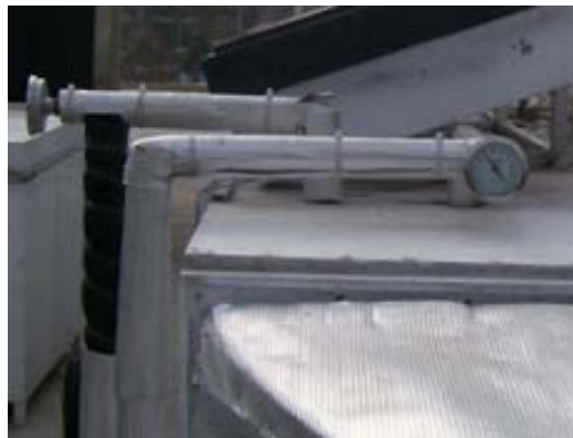
Sensores de temperatura en el deshidratador del CIE en Temixco 2008 [El autor]
