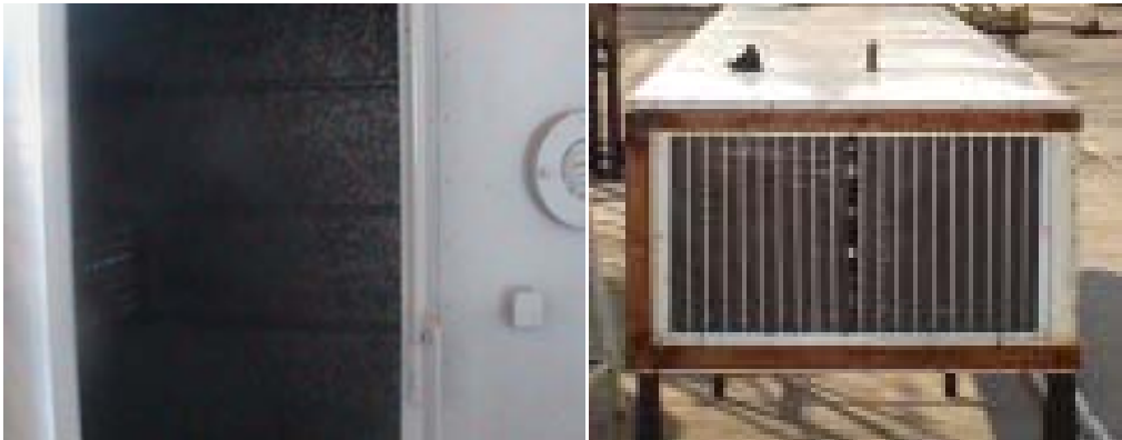
Vista de los gabinetes y los intercambiadores en los deshidratadores del CIE y de Los Azufres 2008 [el autor]
