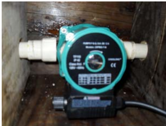
Vista de la bomba de recirculación.
