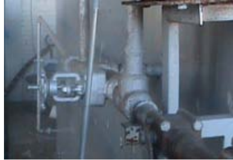
Vista de la tubería y válvula de regulación por donde circula la salmuera geotérmica 2008 [El autor]
