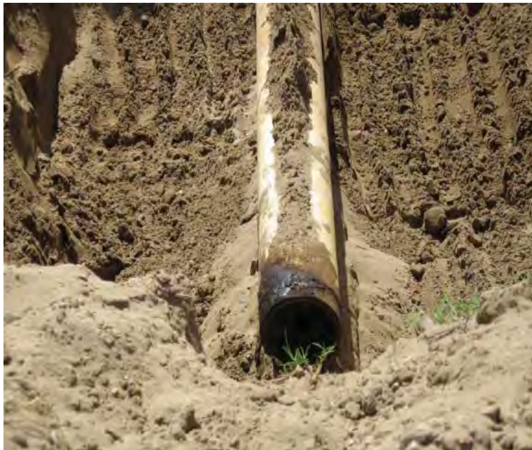
Figura IV.5 Tubería de Producción con depósito de asfalteno correspondiente al pozo A.
