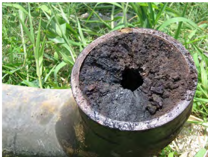
Figura IV.4 Sección de tubería de línea de escurrimiento de 8" con depósito de asfalteno perteneciente al pozo A.
