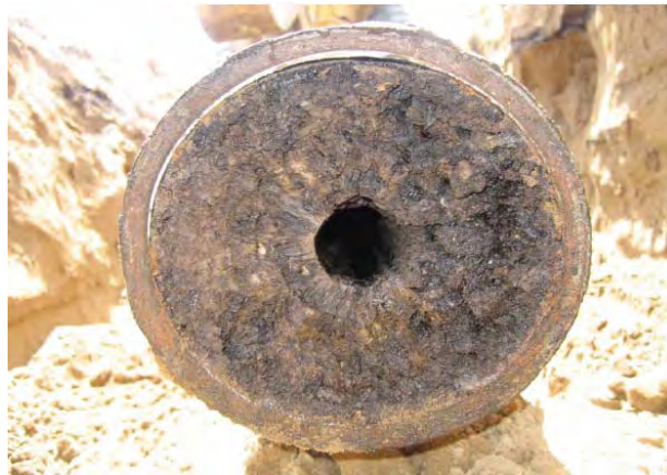
Figura IV.2 Sección de tubería de línea de escurrimiento con depósito de asfalteno perteneciente al pozo A.
