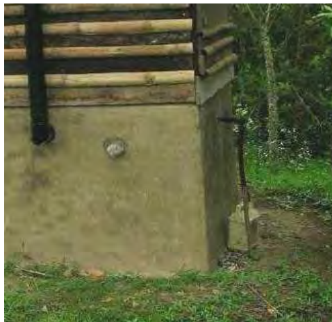
Figura 4.13 Tubería de ventilación.
