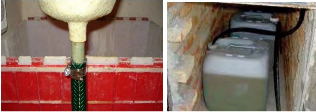
Figura 4.12 Pipi ducto y contenedor de orina.
