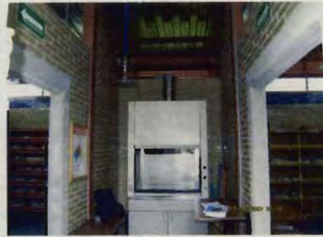
Campana de extracción de la bodega
