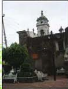
Los servicios de instalaciones del templo, junto con letrero de avisos, y alumbrado público, no están pensados como parte integral del edificio, pero sí contribuyen a su deterioro.
