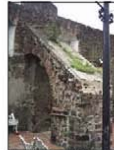
La falta de mantenimiento arroja la invasión de vegetación parásita.
