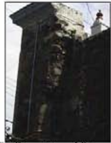
Erosión y falta de consolidación en contrafuerte de fachada debido a la intemperie y falta de aplanado.
