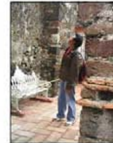
Los materiales de elaboración de los muros son de piedra brasa y ladrillo en los cuales se puede apreciar la pérdida de junta debido al intemperismo que se encuentra, se da de igual manera la erosión de los materiales de construcción.
