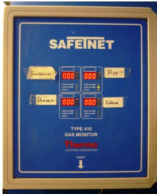
Caja controladora de sensores de H 2 S. Con alarma audible y visual si se exeden los niveles.
