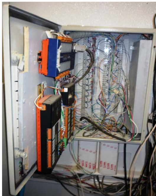
Caja de conexiones. Lugar dónde llegan todas las terminales de los sensores.
