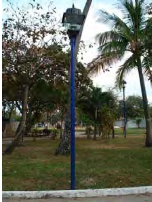
FIGURA 57. Luminaria de poste.
