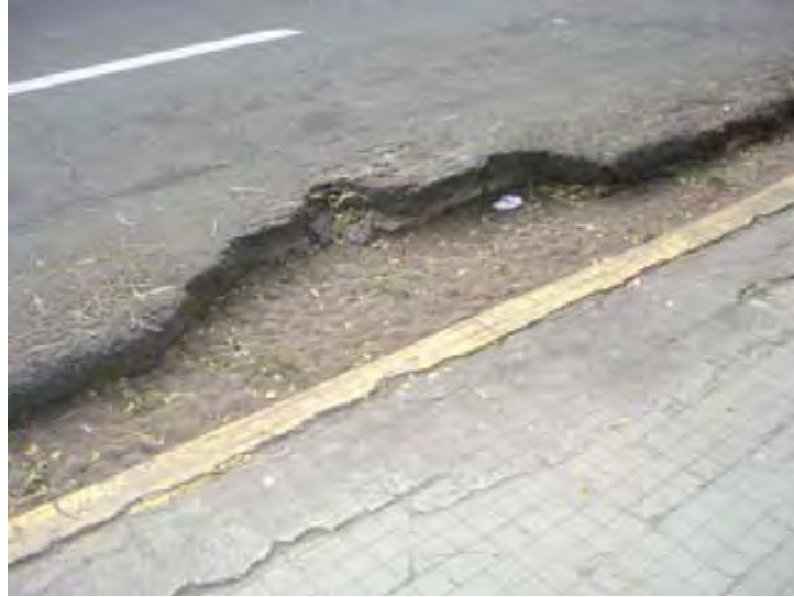
FIGURA 65. Carpeta asfáltica colindante en mal estado.
