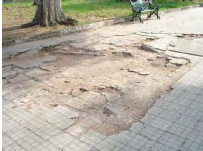
FIGURA 63. Deterioro de losa en andadores.
