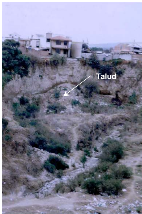
Figura 3.21 Barranco Briones Sección Baja. En las márgenes hay caída y formación de taludes, por lo que las viviendas que se encuentran sobre las paredes son vulnerables.
