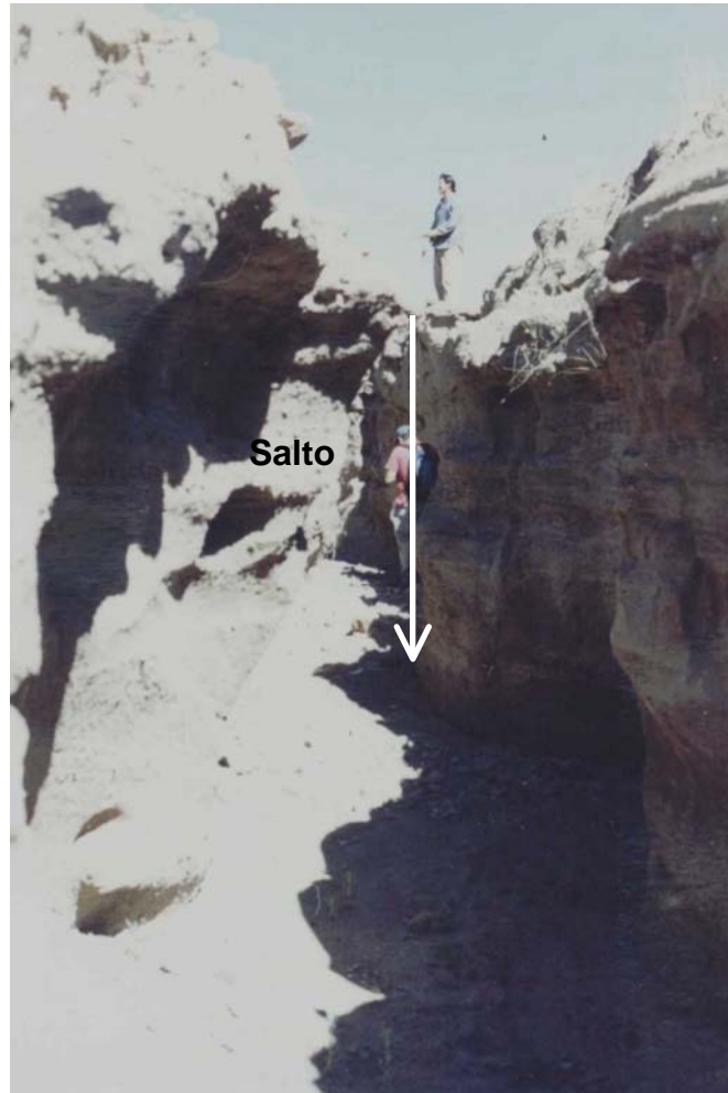
Figura 3.8 Barranco Ramontla Sección Baja. En el lecho del barranco existen una serie de saltos cuya profundidad llega a ser de hasta 2.50 m.
