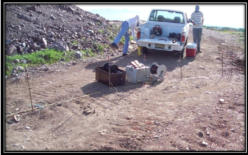
Instalación del Equipo de Exploración Geoeléctrica para Realizar el SEV-5.
