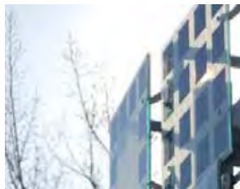
Fig. 62 Instalación luminica y de placas fotovoltaicas alojada en el muro cortina del Xicui entertainment complex Pekín, 2008 Fuente: www.greenpix.org
