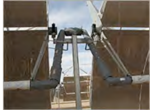
Figura 25. Unión entre módulos solares (Troughnet).
