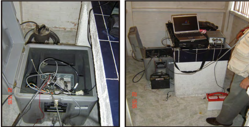
Figura 4.3: estación LUCI, se muestra el equipo instalado, se puede observar que el sensor se encuentra alimentado por baterías de 12 V, el enlace al sensor es por medio de una computadora portátil.
