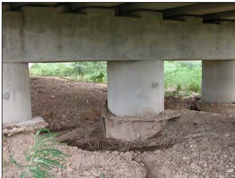
Fotografía 2 Socavación al pie de las pilas del puente del río Lagartero
