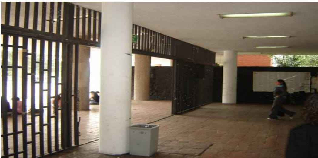
Fig. V.2.5.3. Columnas por confinamiento con el sistema MBrace en la Facultad de Derecho (Entrepiso Planta Baja), localizadas en la salida a la zona de Islas.
