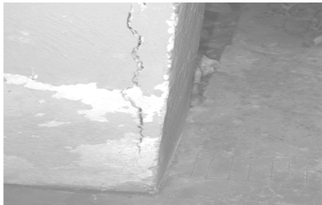
Fig. III.8.1 Agrietamiento por corrosión de acero de refuerzo en una columna
