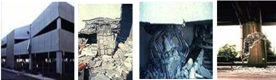
Fig.III.10.3.1. Falla en columnas cortas durante sismos, por estructuras aporricadas con tabiques de albañilería como relleno.
