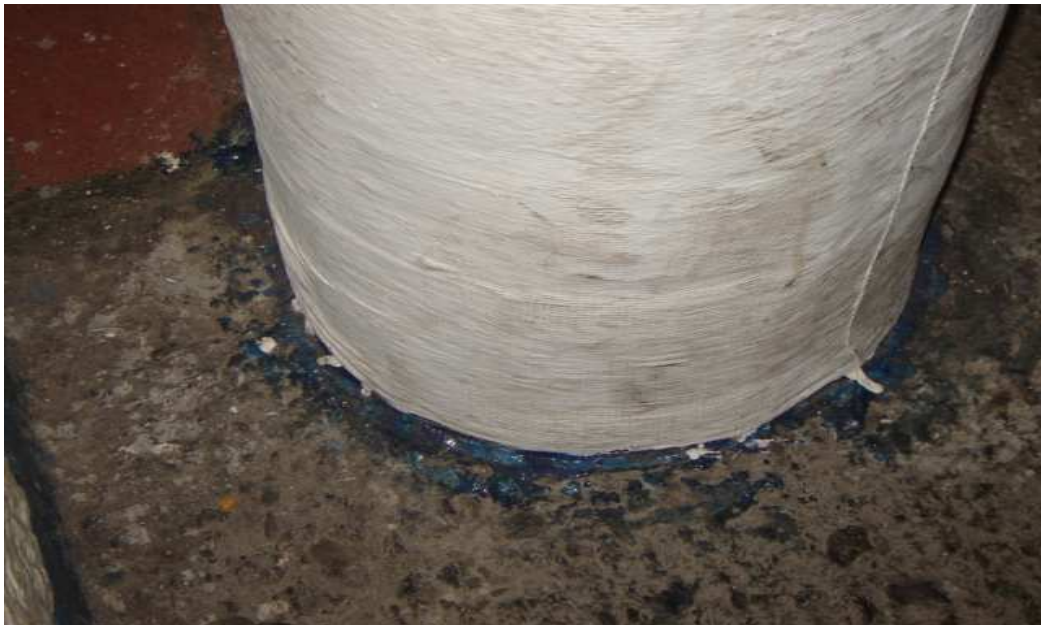
Fig. V.2.5.5. Detalle de la columna por confinamiento (Entrepiso 1), localizada escaleras sur.
