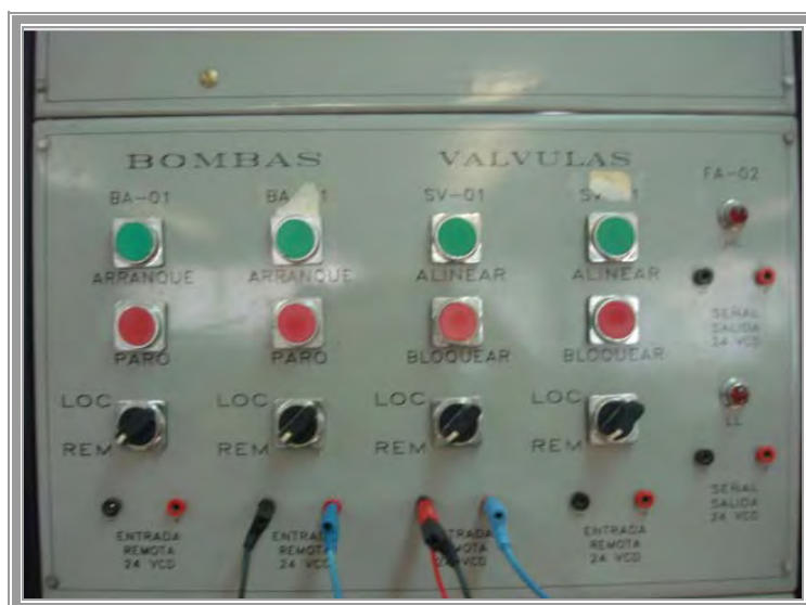
Figura 3.21. Foto Gabinete de conexiones.
