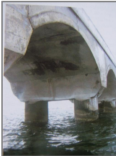
Fig. 4.2 Acero de refuerzo afectado por cloruros en el ambiente marino
