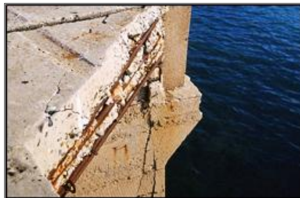
Fig. 3.1 Exposición de acero de refuerzo debido a corrosión.
