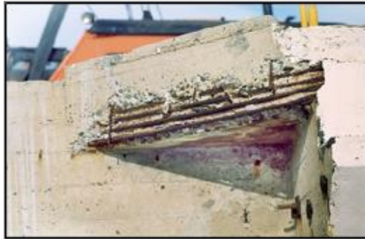
Fig. 4.5 Afectación de concreto armado por falta de mantenimiento
