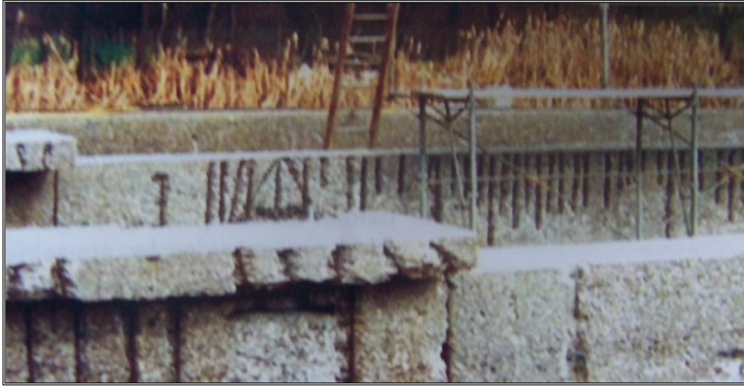
Fig. 4.4 Concreto armado afectado por la carbonatación
