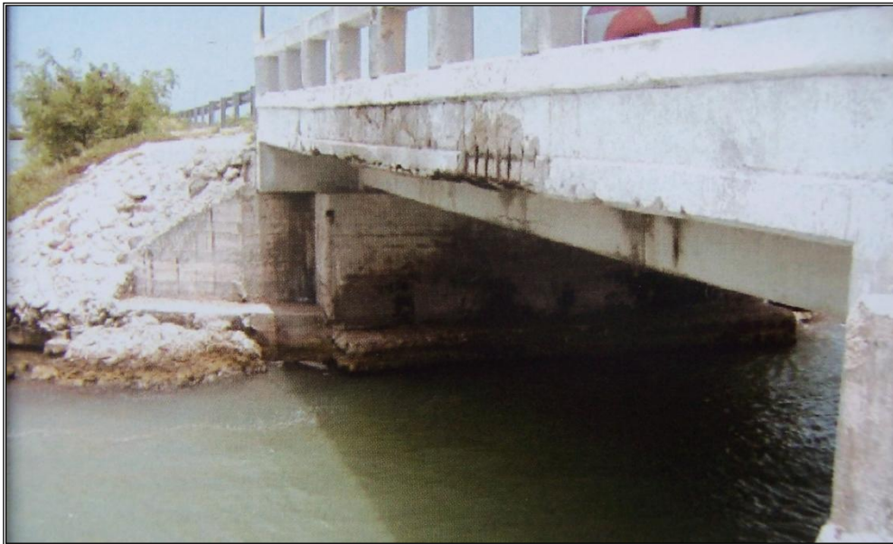
Fig. 3.3 Exposición de acero de refuerzo, al perder el recubrimiento colocado debido al incremento del volumen del refuerzo y el posterior desprendimiento del concreto.
