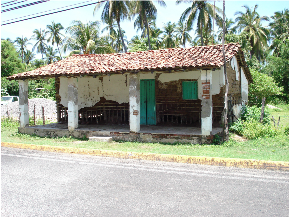
Imagen IV.7 En esta imagen se puede apreciar el desgaste ocurrido en las viviendas cuando acontece un desbordamiento de ríos y/o lagunas. Vivienda de Espinalillo en el municipio de Coyuca de Benítez.
