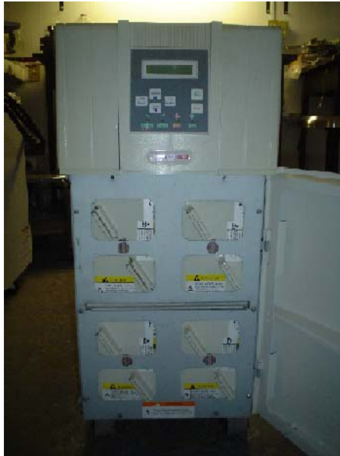
Figura 10.2 Gabinete de baterías del UPS serie 1600
