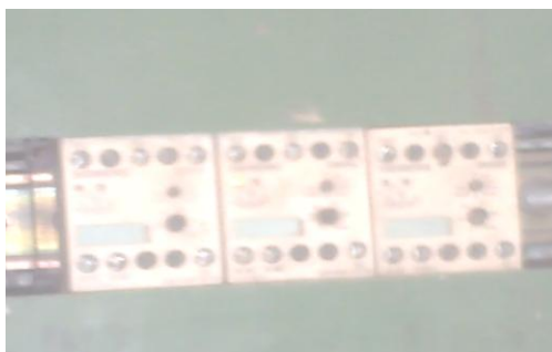
Figura 2.10 Relevadores de control.
