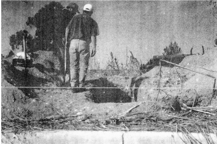
Fotografía No 3. Panorámica de la Cala 03 en Camellón del Río de los Remedios, a la altura de la calle Margarita.
