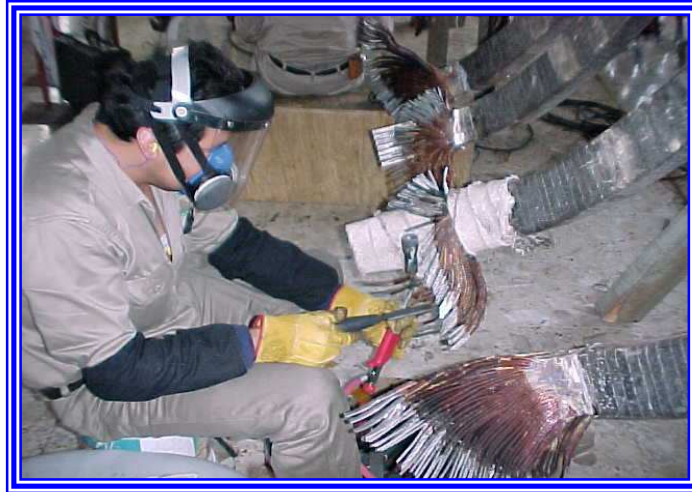
Fotografía 5.10 Limpieza de terminales de puentes, salida de fases y neutro del generador
