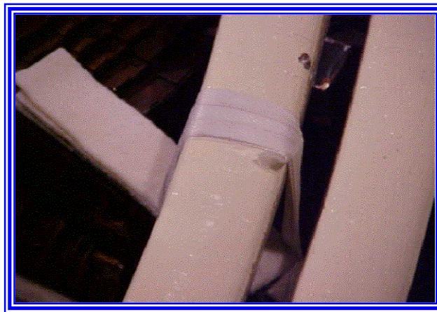
Fotografía 5.18 Amarre entre bobinas inferiores y aro de micarta
