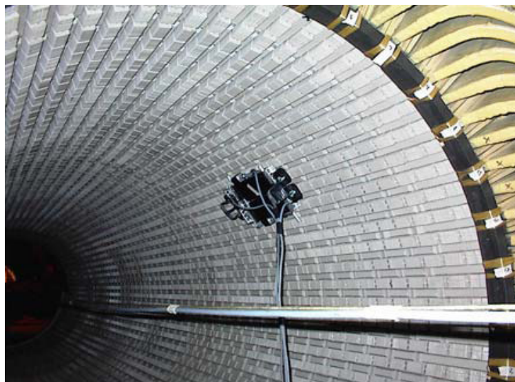
Figura 4.7 Ensayo de flujo reducido EL-CID mediante el uso de vehículo robotizado. Véase los cables de excitación ocupando el eje del rotor extraído del estator.
