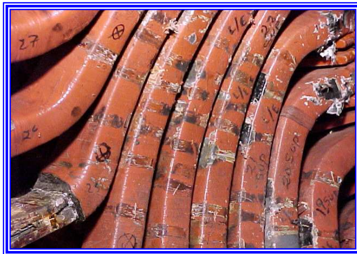
Fotografía 5.3 Muestra separación de bobinas
