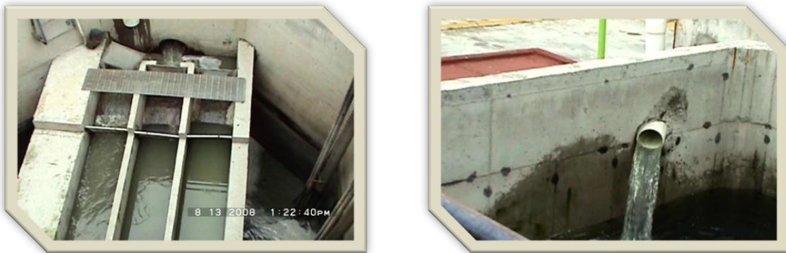
Fig. 5.5 A la izquierda, afluente de agua residual y a la derecha efluente de agua tratada.
