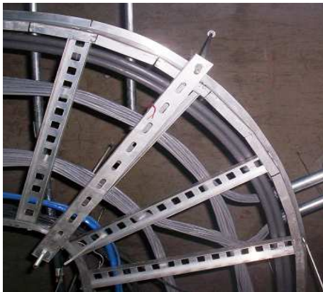
Figura 3.30. Trayectoria del cableado UTP 5e para datos, por medio de la escalerilla.
