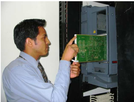
Figura 3.41. Colocación de tarjetas del conmutador.
