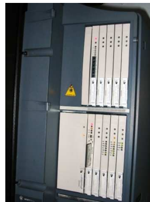
Figura 3.42. Vista de las tarjetas que integran el conmutador.
