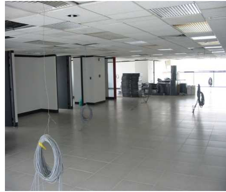
Figura 3.33. Vista del sexto piso, una vez terminados los trabajos de remodelación y cableado horizontal.
