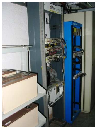
Figura 3.45. Concentrador de servicios de Telmex.
