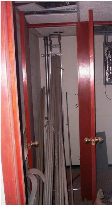
Figura 3.14. Aspecto inicial del clóset de telecomunicaciones del primer piso.
