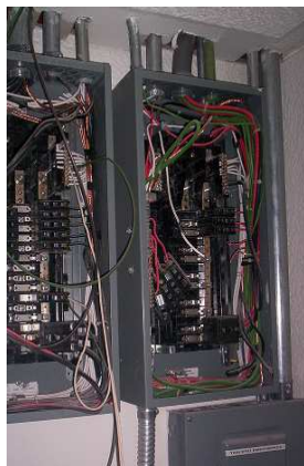
Figura 3.26. Tablero eléctrico del primer piso.
