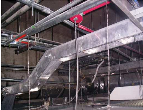
Figura 3.28. Escalerilla para cableado del sexto piso.
