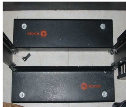
Figura 3.31. Fijación de los racks en los clósets.
