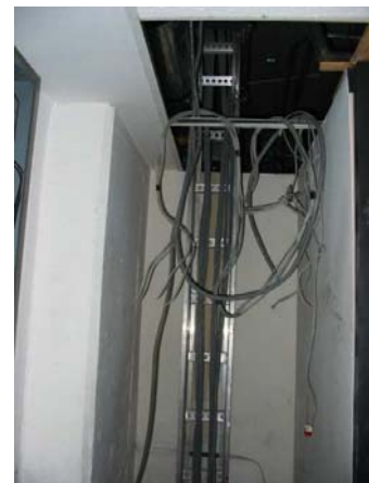
Figura 3.18. Aspecto inicial del clóset de telecomunicaciones del sexto piso.
