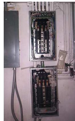
Figura 3.27. Tablero eléctrico del sexto piso.
