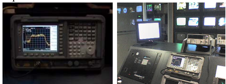
Fig.4.29 Espectroscopio mostrando el BW de la portadora de los 16 canales de la Red Edusat
