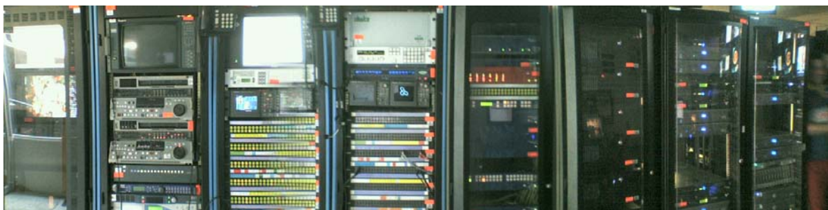
Fig. 4.11. Parte del equipo con el que cuenta la central de conmutación
