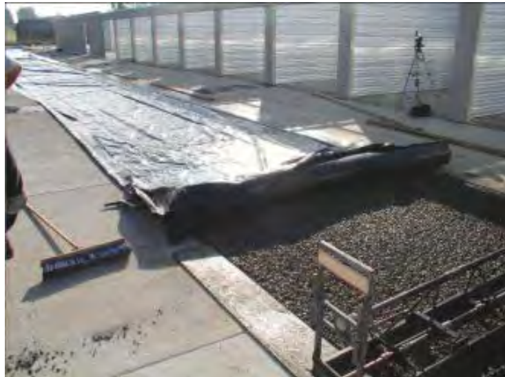
Figura 4.10 Material de polietileno utilizado para cubrir la superficie expuesta del concreto permeable (Tennis et al., 2004).
