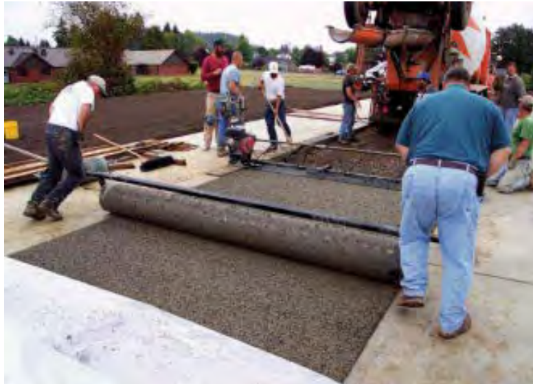
Figura 4.7 Compactación del concreto permeable mediante el uso de un rodillo (Tennis et al., 2004).
