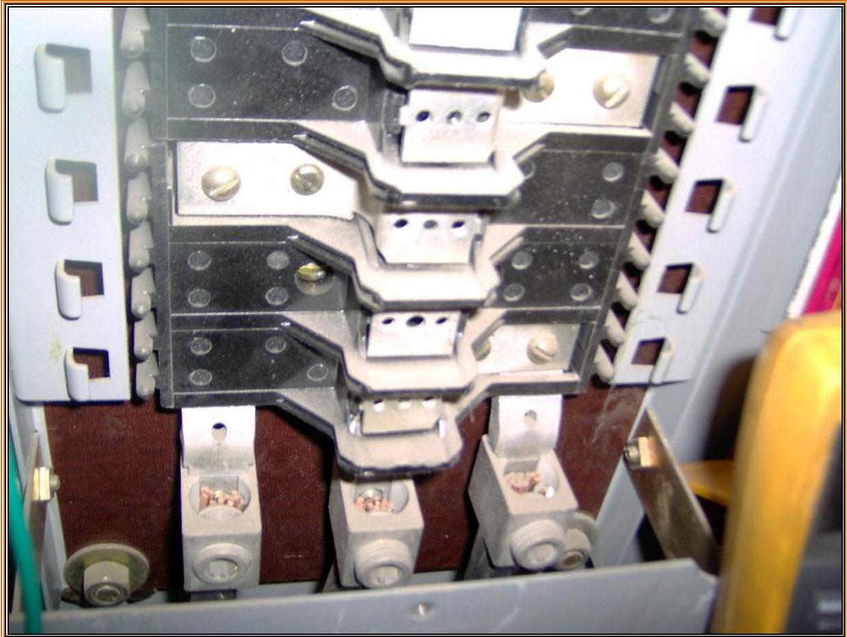
Fotografía 0-4. Conexión de Las tres fases en el panel de switcheo
