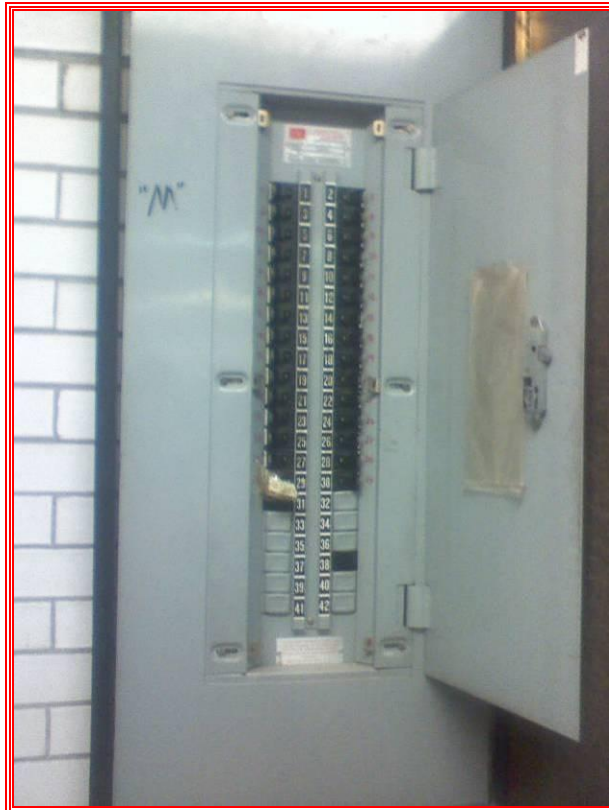
Fotografía I-4. Panel de switcheo
