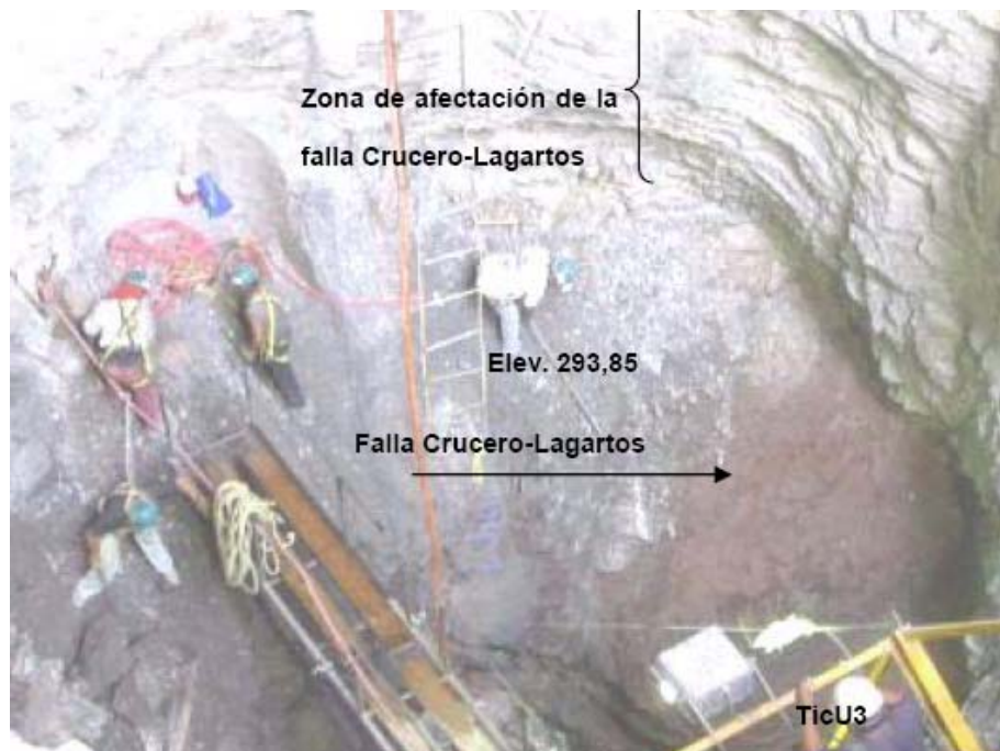
Fotografía IV.6.- Vista de la excavación de la tubería a presión 2 (tramo inclinado) a la elevación 293,85, nótese la mala calidad de la roca, alterada y muy fracturada, en el piso aflora uno de los planos de la falla Crucero-Lagartos.
