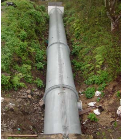
Fotografía III.2.1 Tubería Superficial donde se muestran a traques y silletas.
