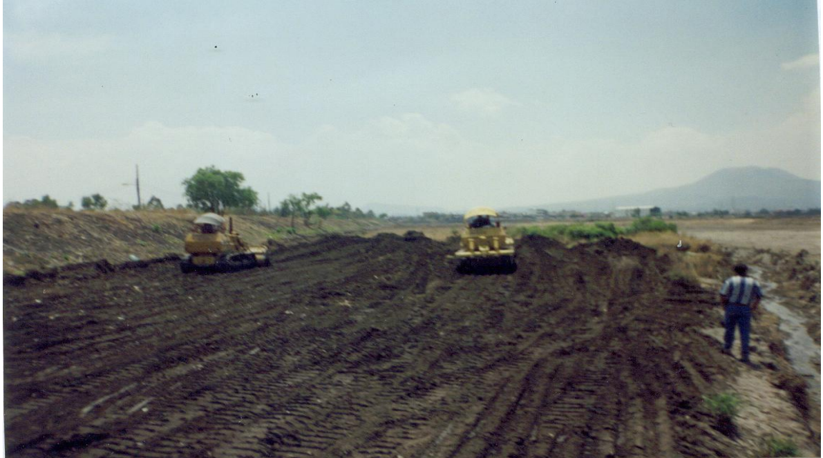
CORTE DE TERRENO (AZOLVE) Y FORMACIÓN DE BANCOS PARA DESHIDRATACIÓN DEL MATERIAL.
