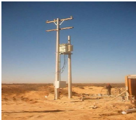
Fig. 2.4 Subestación aérea tipo poste
