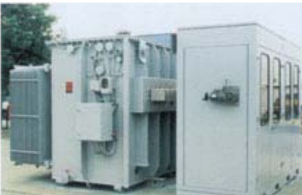
Fig. 2.1 a) Subestación compacta
