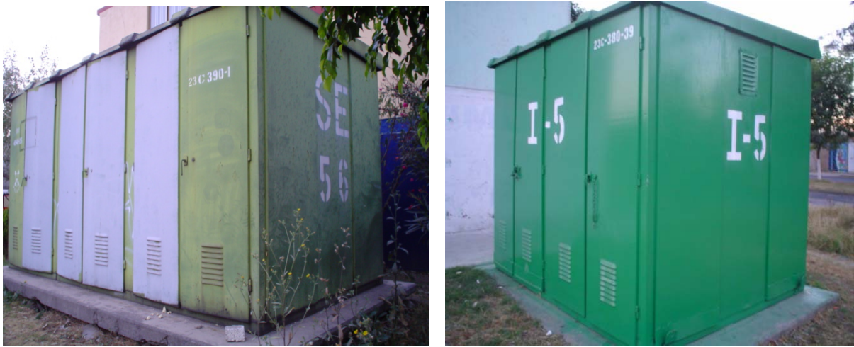
Fig. 2.6 Subestaciones tipo Pedestal
