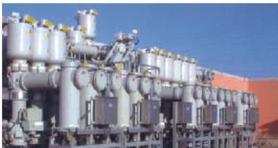
Fig. 2.5 a) Subestación encapsulada
