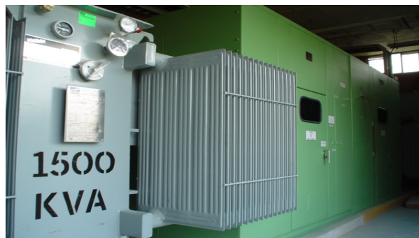
Fig. 2.3 Subestación Tipo Interior
