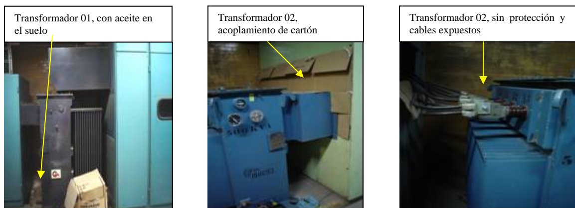
Fig.5.5 Transformadores principales en condiciones no adecuadas
