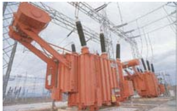
Fig. 2.1 b) subestación abierta
