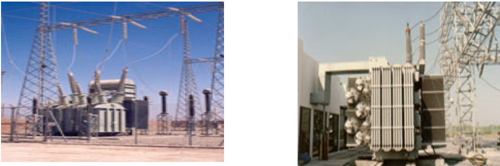
Fig. 2.2 Subestaciones tipo intemperie
